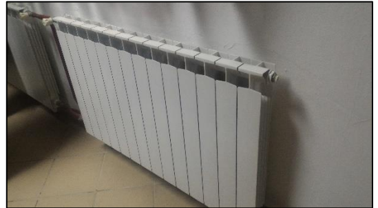
Slika 14. Ogrjevno tijelo - radiator
