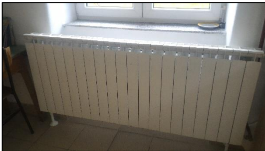
Slika 15. Ogrjevno tijelo - radiator
