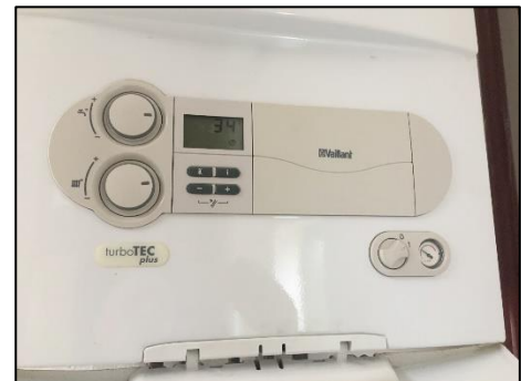
Slika 16. Upravljačka ploča kombi bojlera
